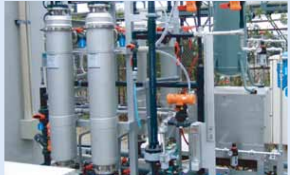
〈ピューリア®〉GSを用いた地下水浄化装置
