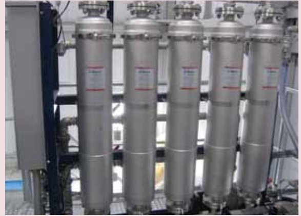
〈ピューリア®〉SLを用いた砂ろ過逆洗水の回収
