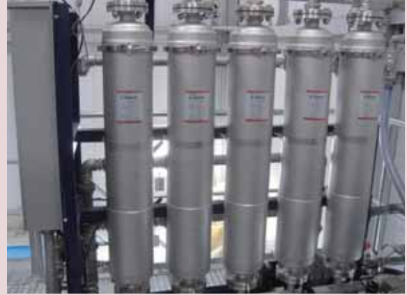
〈ピューリア®〉SLを用いた砂ろ過逆洗水の回収
